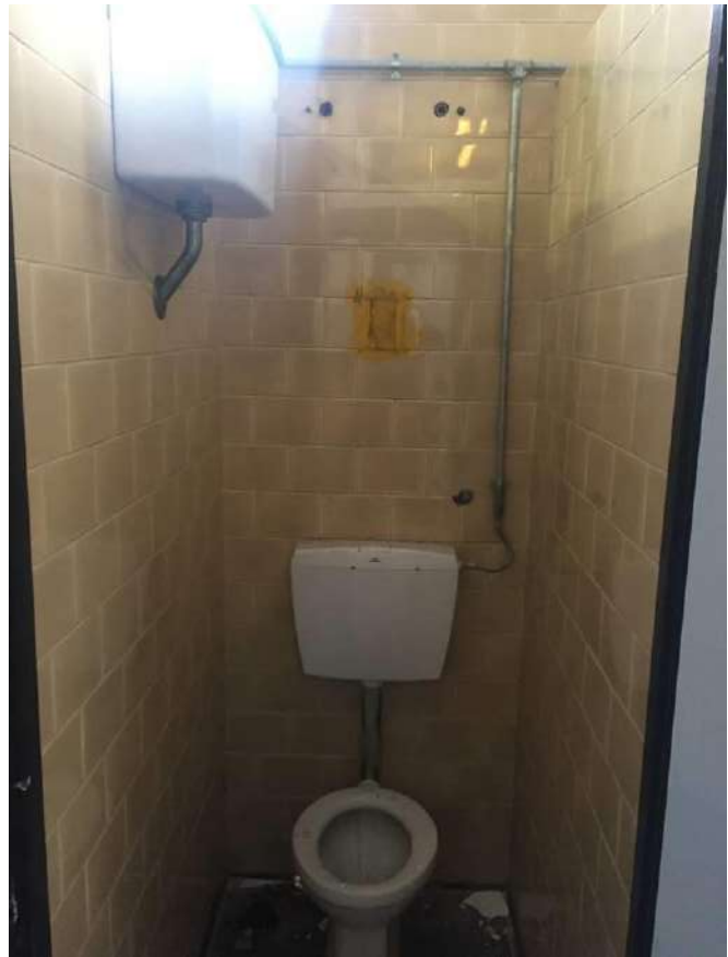
Vista W.C. da sostituire
